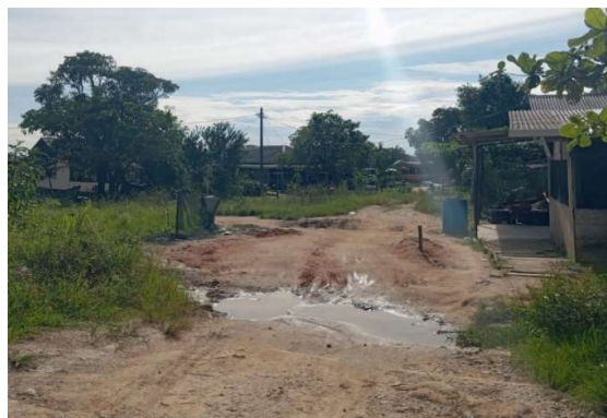
Gambar 13 Kondisi jalan menuju objek wisata Pantai Batu Gajah
